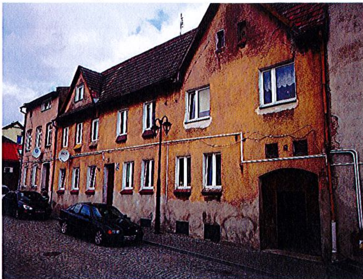
Rysunek 55. Zniszczone elewacje kamienic w obszarze rewitalizacji
