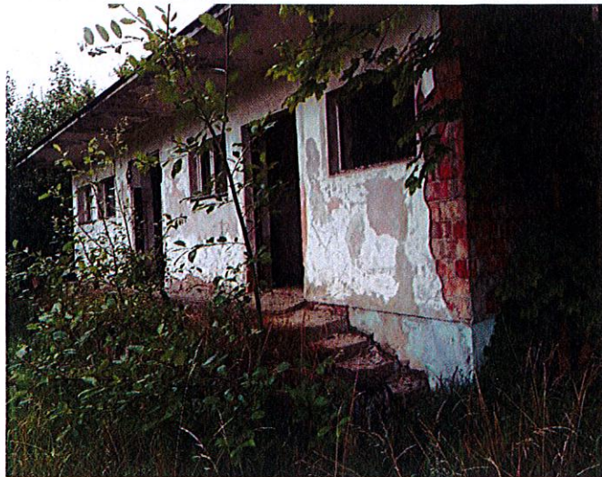
Rysunek 17. Zniszczone zabudowania zlewni mleka - Ubysławice
