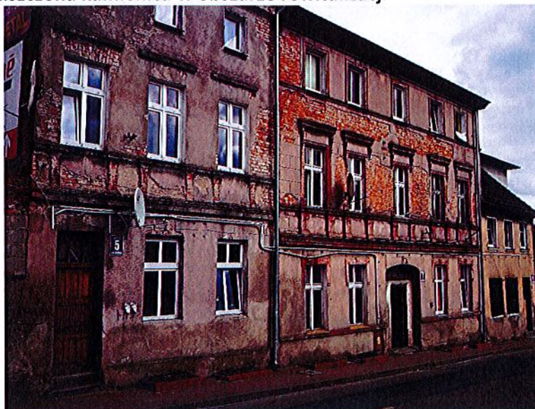
Rysunek 53. Zniszczona kamienica w obszarze rewitalizacji
